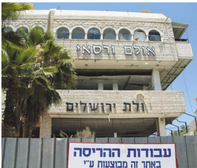
Bild 2. Banketthallen Versailles en månad efter raset. Sedd i denna vinkel kan man bara ana skadorna.
