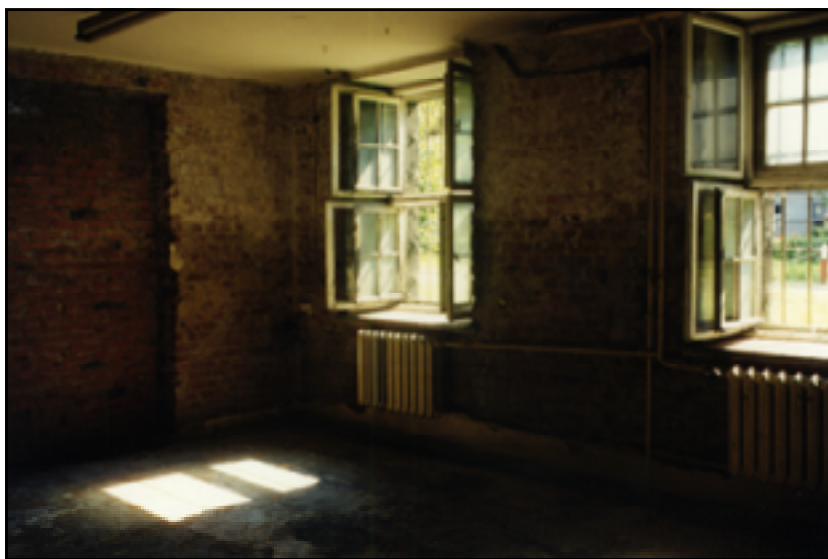
Bild 5. Sjukhusets bottenvåning översvämmades. Putsen har knackats bort och solen hjälper till att torka. Foto: H.Wahren.
