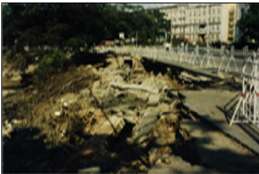
Bild 3. Flodvattnet orsakade skador på vatten och avloppsledningar. Foto: H.Wahren.
